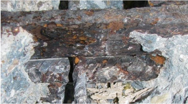
Bild 8: Höhenleere in Bodenfläche, darunter kreuzende Bewehrung
