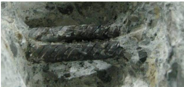
Bild 10: Bewehrung nach 2-jährigem Monitoring
